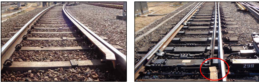
[그림23] 탈선방지 가드레일 설치 현황
