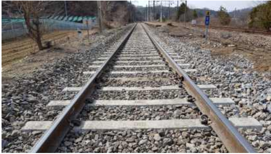
최초 탈선 위치 (영주역 기점 20.405km)
