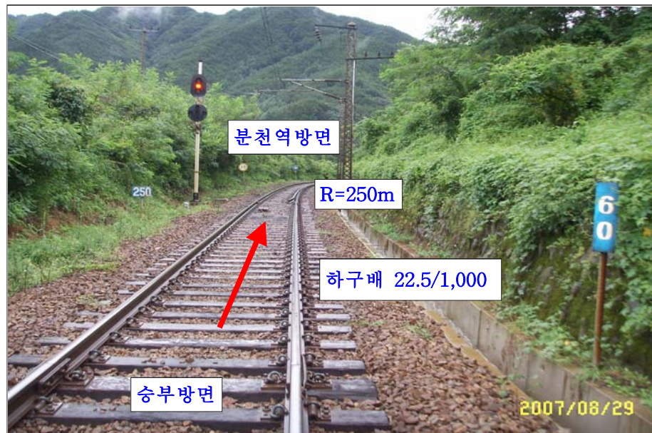
그림 5. 승부방면 → 분천역방면 선로 상태
