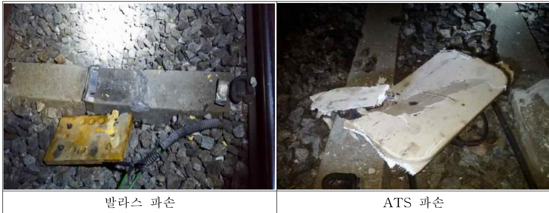
[그림11] 발라스 및 ATS 파손 상태
